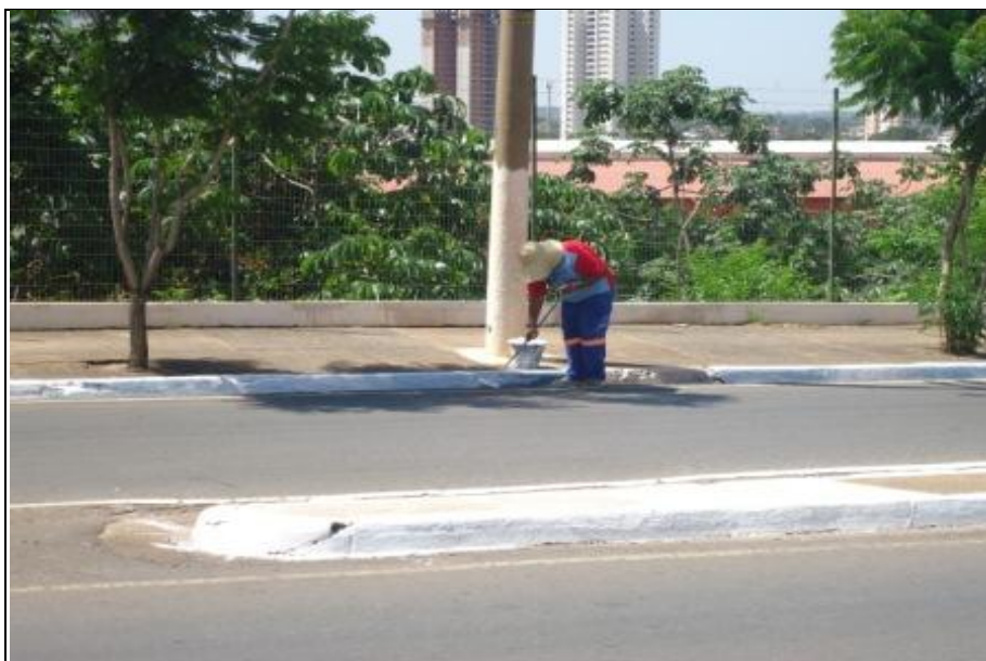
Foto 12: Pintura de meio fio na Avenida Miguel Sutil
